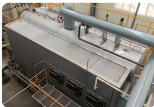
5 스팀보일러 (Steam Boiler)
