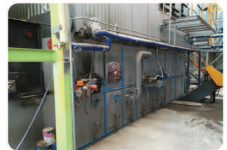
4 연소로 (combustion furnace)
