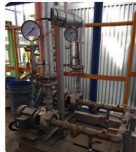
공급펌프 Supply Pump
