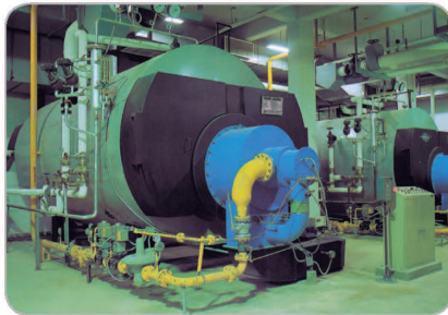
노통 연관식 증기보일러 Overhead Fire Tube Steam Boiler
