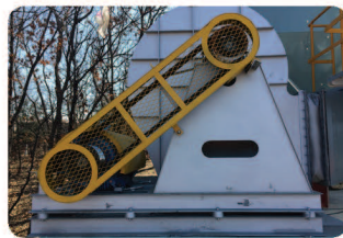
15 유인송풍기 (Induced Draft Fan)
