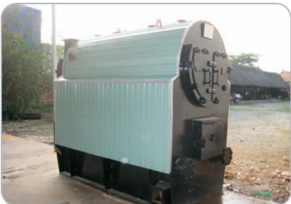
화목 / 석탄보일러 Wood/Coal Fire Boiler
