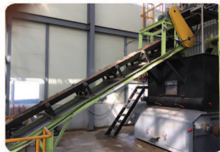
2 투입컨베이어 (Bucket Conveyor)
